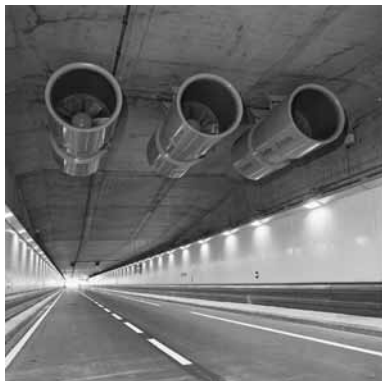
Aplicación de ventilación
