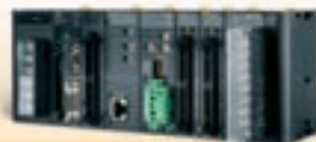
PLC Control de Lazo
